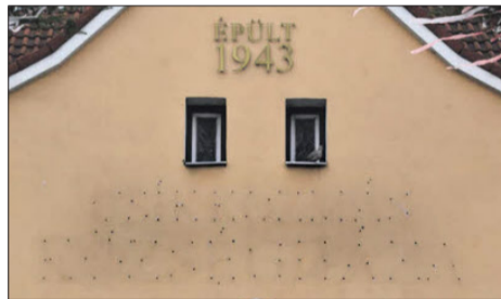
Doch an der Fassade fehlt etwas, Spuren sind noch zu erahnen: Die 1943 beim Bau angebrachte Aufschrift Csikozmás Közseghaza. sch
